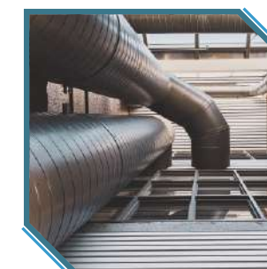
ВЕНТИЛЯЦИЯ И КОНДИЦИОНИРОВАНИЕ
