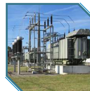
ОБЪЕКТЫ ГЭС, ТЭЦ, АЭС
